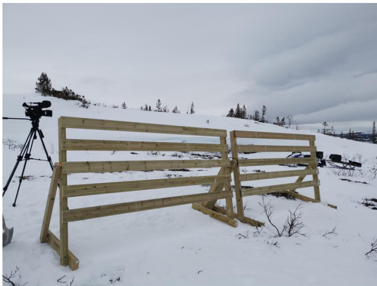
Figur 13: Nærbilde av snøgjerdet som ble installert langs med Storlirennets løype. Snøgjerdet ble installert etter det design som ble testet i Vålådalen, med en porøsitet på 50 %.
